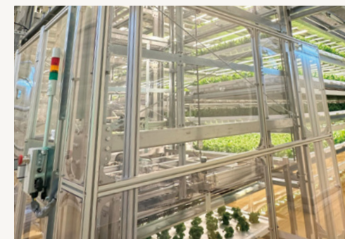
植物工場自動化設備(福井美浜工場)
