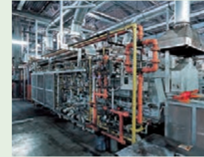
最新のガス炉を導入した熱処理工場
