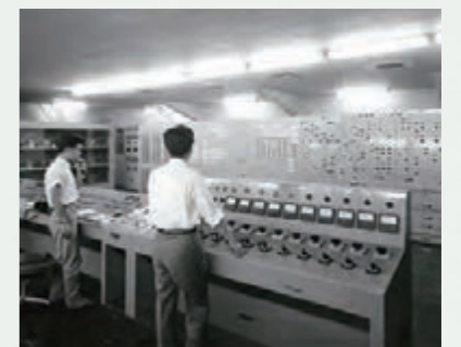
コンベヤ制御が組み込まれた集中制御室
