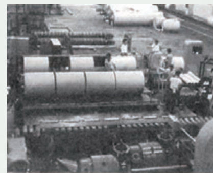
製紙工場に納入された巻取紙搬送コンベヤ
